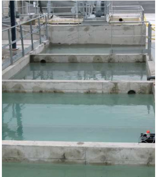
GESTION DES EAUX DE PROCESS - CENTRALE EDYCEM BPE BIGANOS CRÉDIT PHOTO EDYCEM
